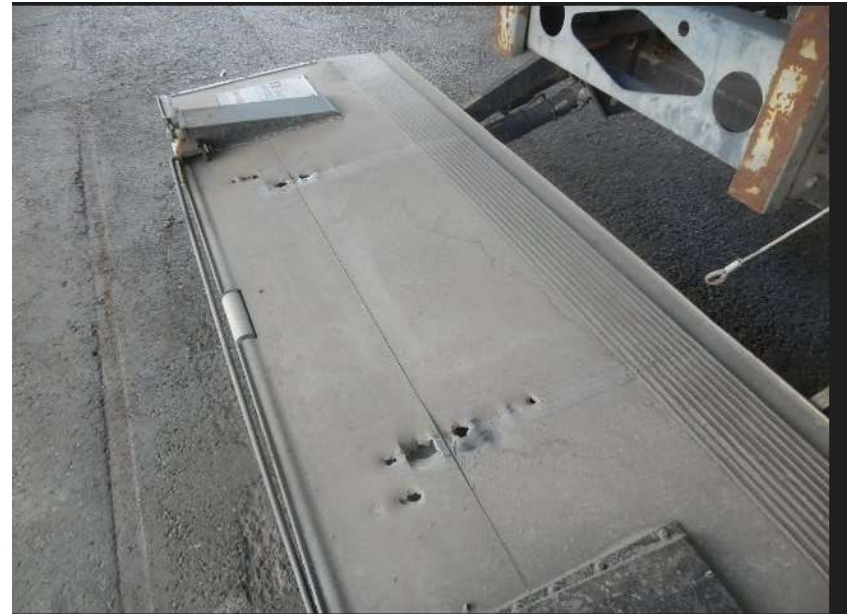
Perforations importantes, à réparer
