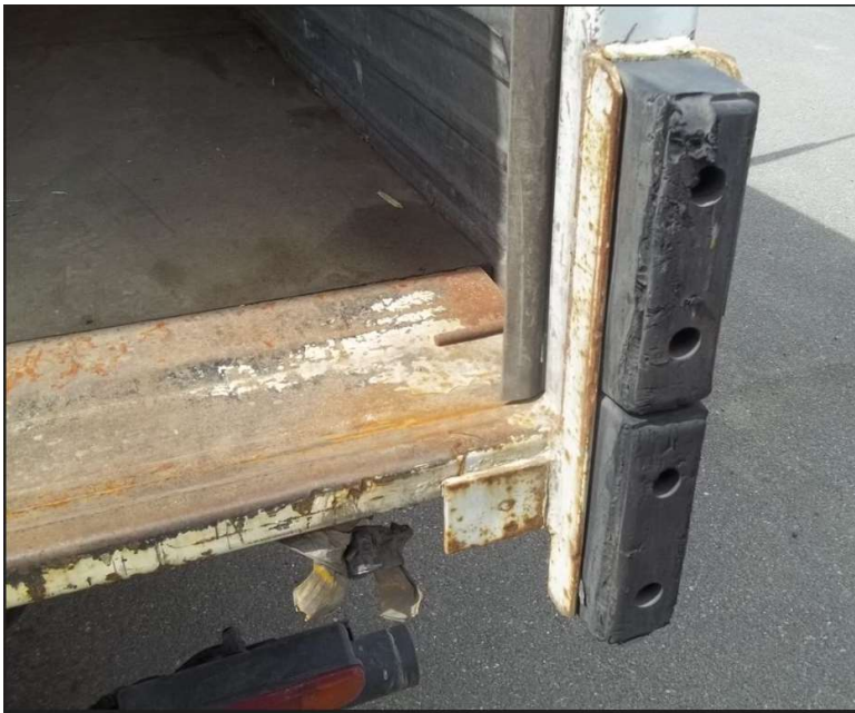
Rouillé mais acceptable, butoirs en place
